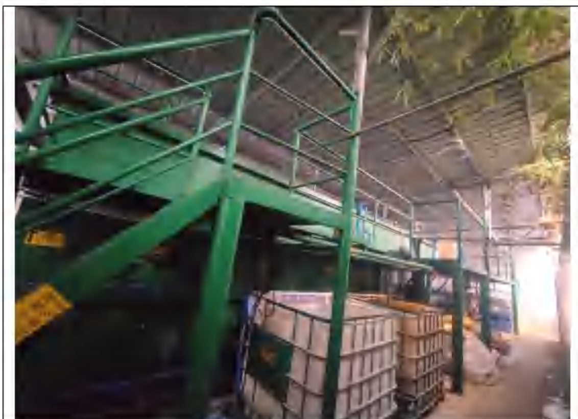
图4-1 自建污水处理系统
